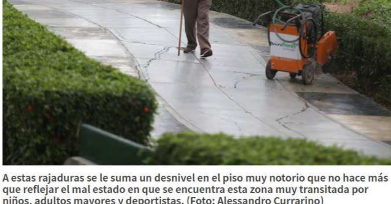
A estas rajaduras se le suma un desnivel en el piso muy notorio que no hace más que reflejar el mal estado en que se encuentra esta zona muy transitada por niños, adultos mayores y deportistas. (Foto: Alessandro Currarino)
